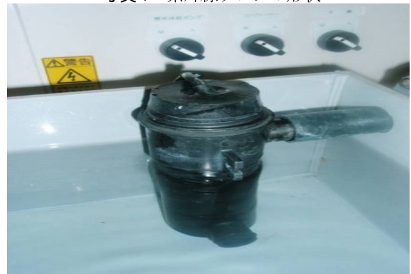
写真2 紫外線ランプ位置 (ろ過槽出口)
