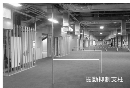
写真3 振動抑制支柱(プレスセンター棟)
