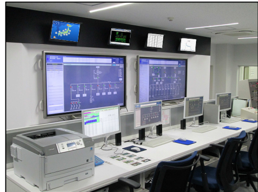
写真2 改修後の中央監視室風景
